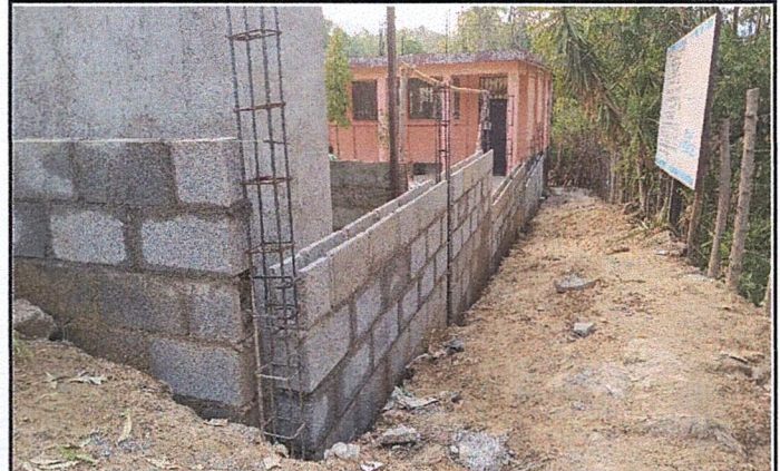
Foto 2: Vista lado Norte, del avance de mejoramiento de cerramiento perimetral del centro educativo.
